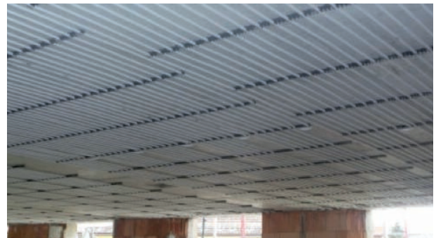
Bild 4: Deckenheiz-/kühlsystem in der Putzschicht integriert.
